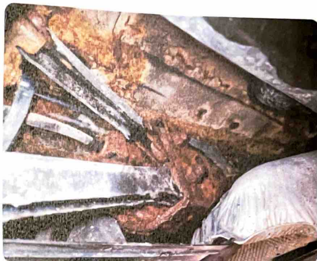
3.1 Rust Mye rust underside ved bakstilling.
