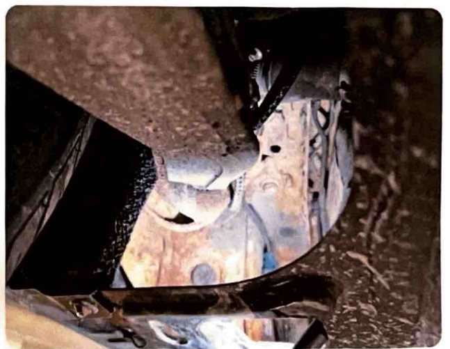
3.1 Rust Mye rust underside ved bakstilling.
